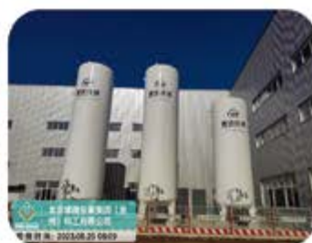
厂区集中供气系统
