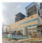
山东鲁西发电项目
