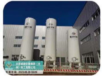
厂区集中供气系统
