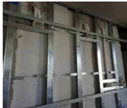
贴面墙处管线与墙板分离
