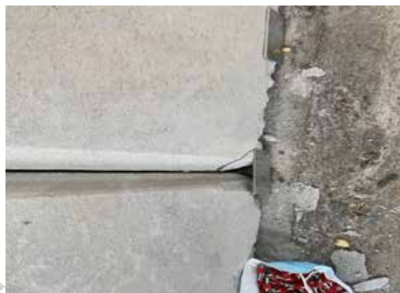
图 4-20 外墙板局部破损
