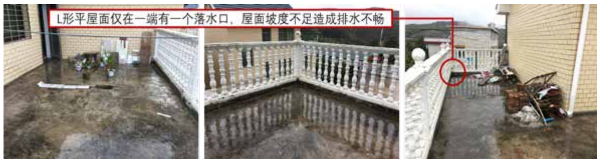
坪石村屋面坡度不足、仅 1 个落水管
