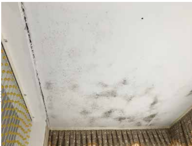
室内屋面漏水处
